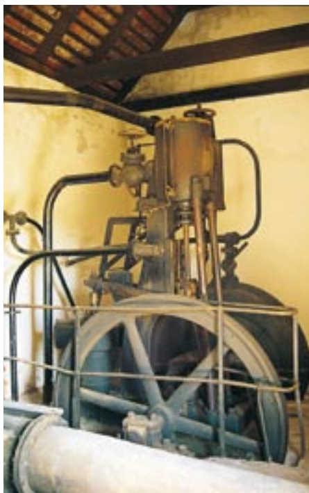
Silnik parowy przepompowni w Rózanach
