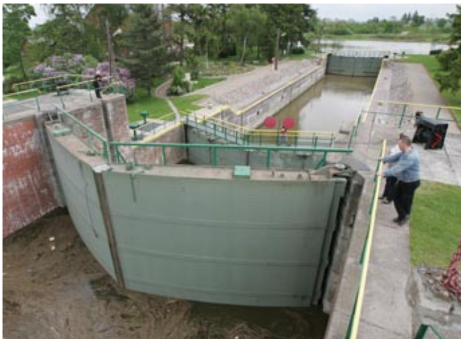
Śluza i wrota przeciwpowodziowe Gdańska Głowa
