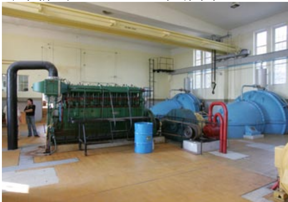
Stacja pomp w Rybinie odwadniająca polder Chłodniewo
