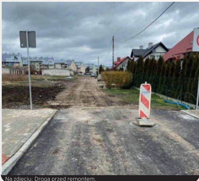
Na zdjęciu: Droga przed remontem.
